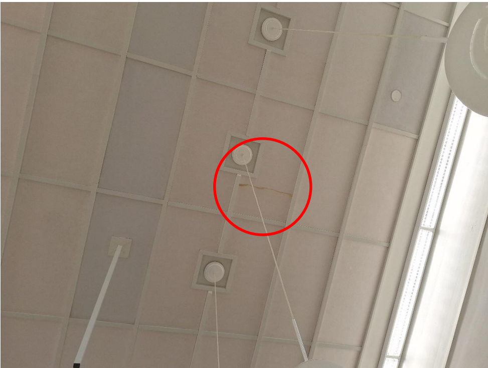
Kuva 24. Kuivunut vesijälki kirjastosalin katossa.
