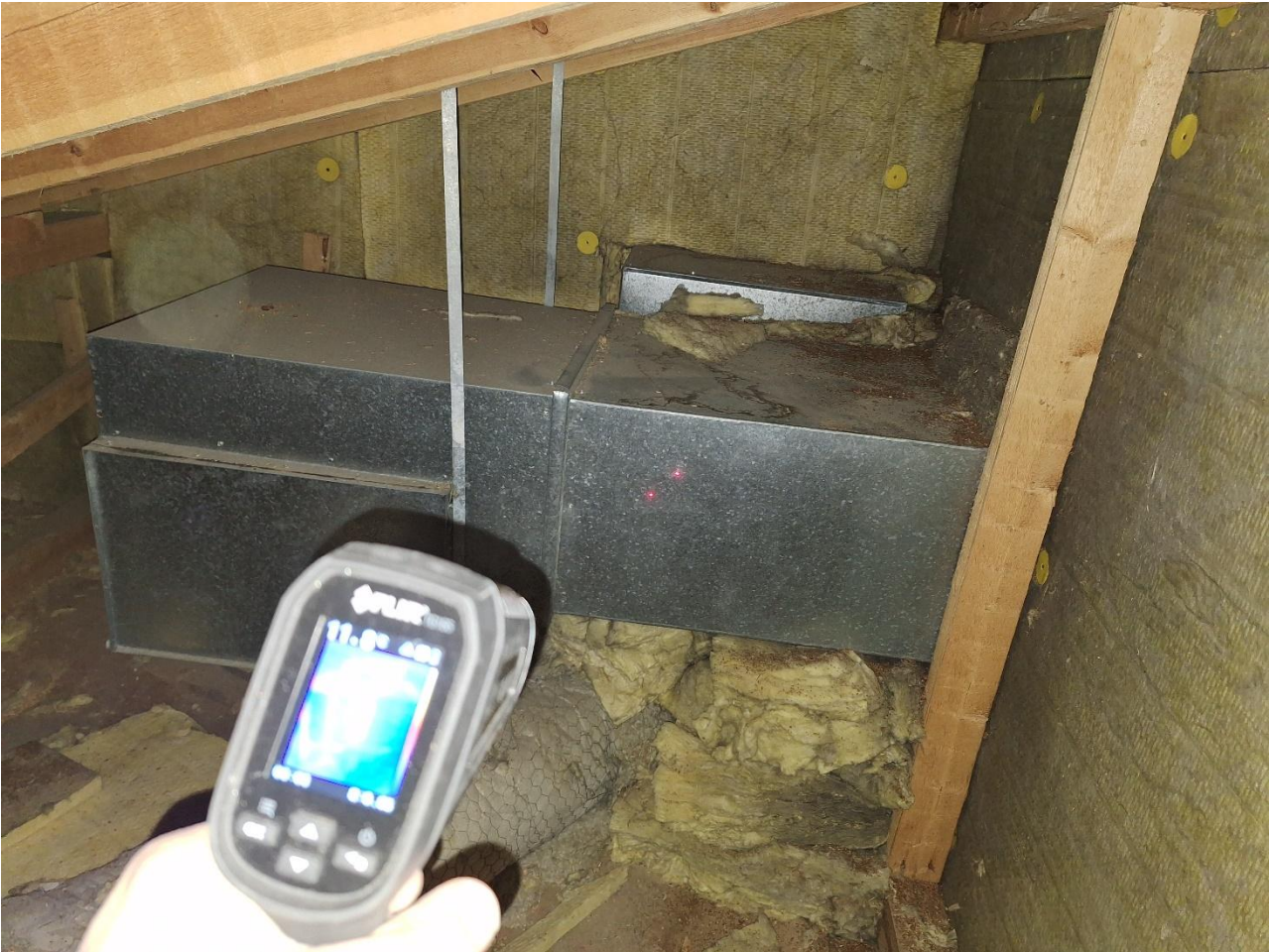
Kuva 45. Tuloilmakanavistossa on tuulettuvassa yläpohjassa lyhyt osuus, jota ei ole lämpöeristetty. Tämä voi johtaa veden kondensoitumiseen sekä kanavan sisä- että ulkopuolella riippuen sääolosuhteista. Kuvassa olevat vesijäljet kanaviston päällä ja seinävillassa johtuvat todennäköisesti tuulella ja sateella yläpohjaan päässeestä vedestä.
