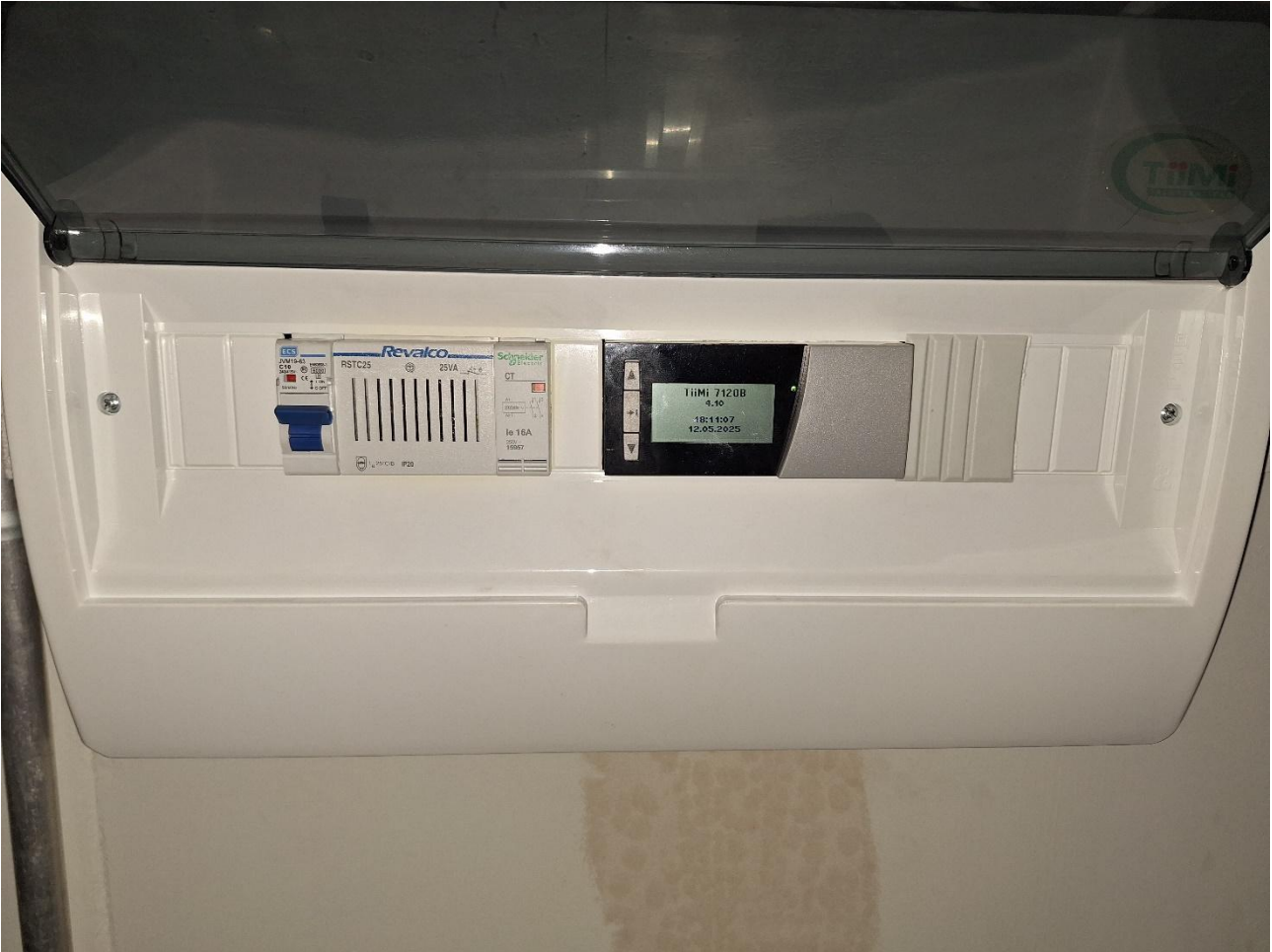
Kuva 37. Ilmanvaihtoa säädellään TiiMi 7120B -ohjaimella.
