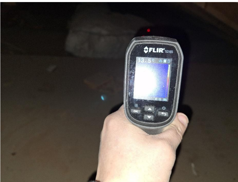
Kuva 46. Lepohuoneen tuloilmakanavan päätelaite on huonosti eristetty. Tilanne voi johtaa veden kondensoitumiseen tuloilmaelimessä.
