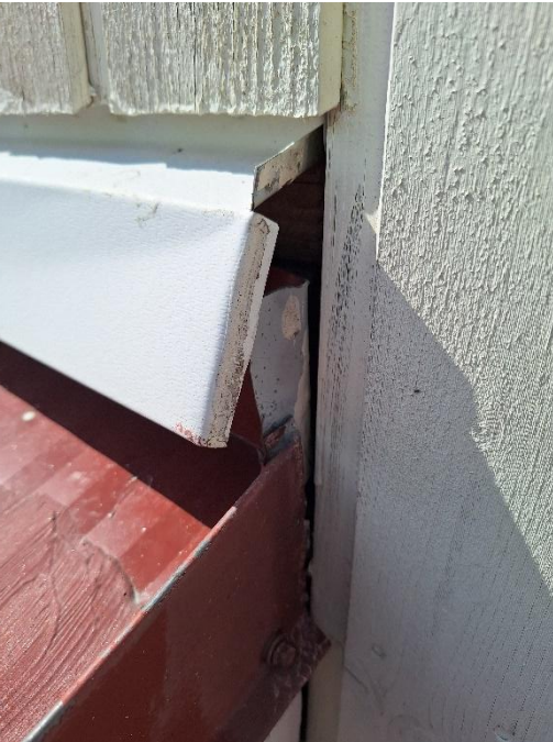
Kuva 31. Kellon vieressä olevassa rintapellityksessä on reitti rakenteisiin.
