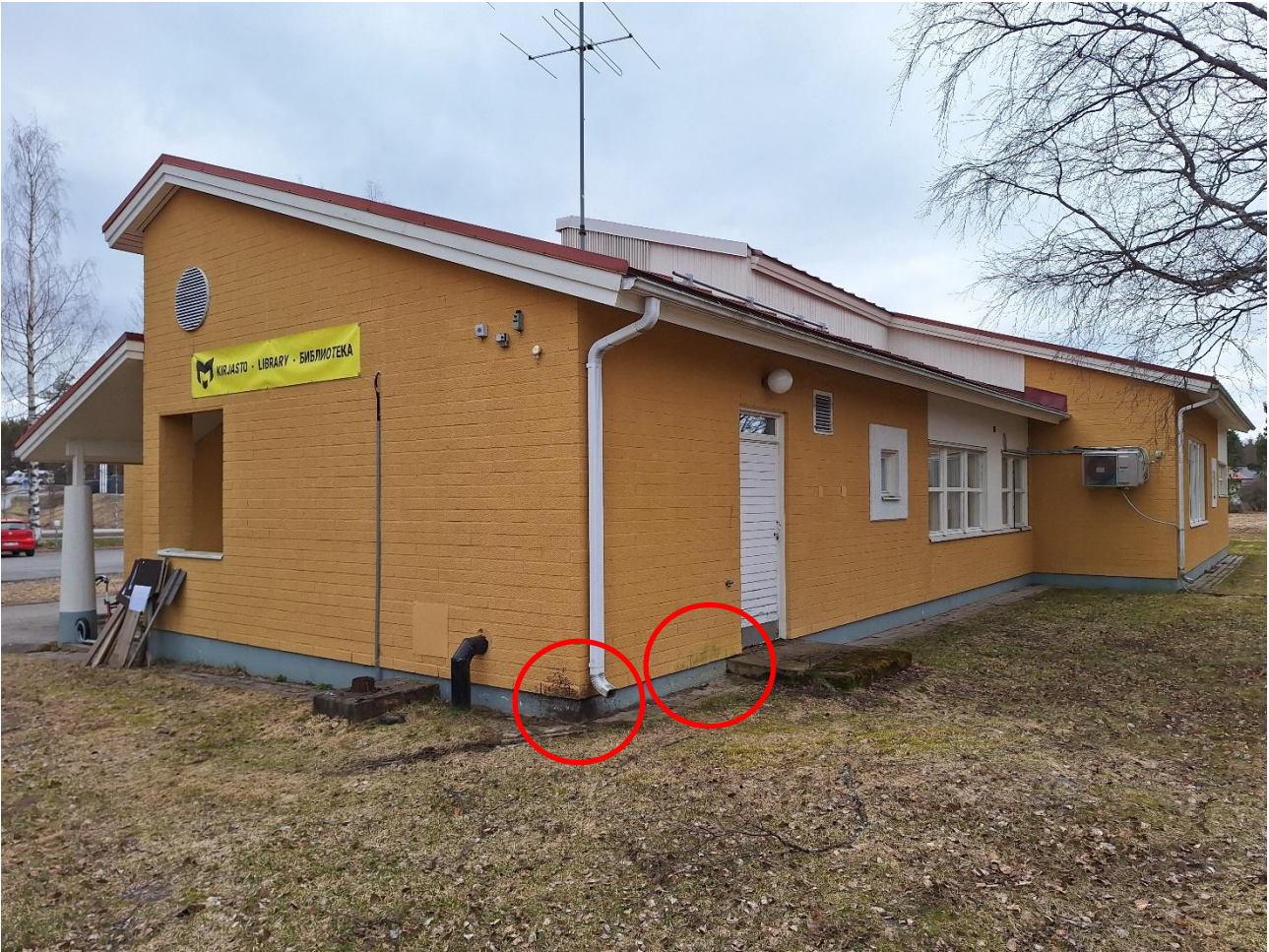
Kuva 2. Sadevedet kastelevat ulkoseinää rakennuksen pohjoisnurkalla.
