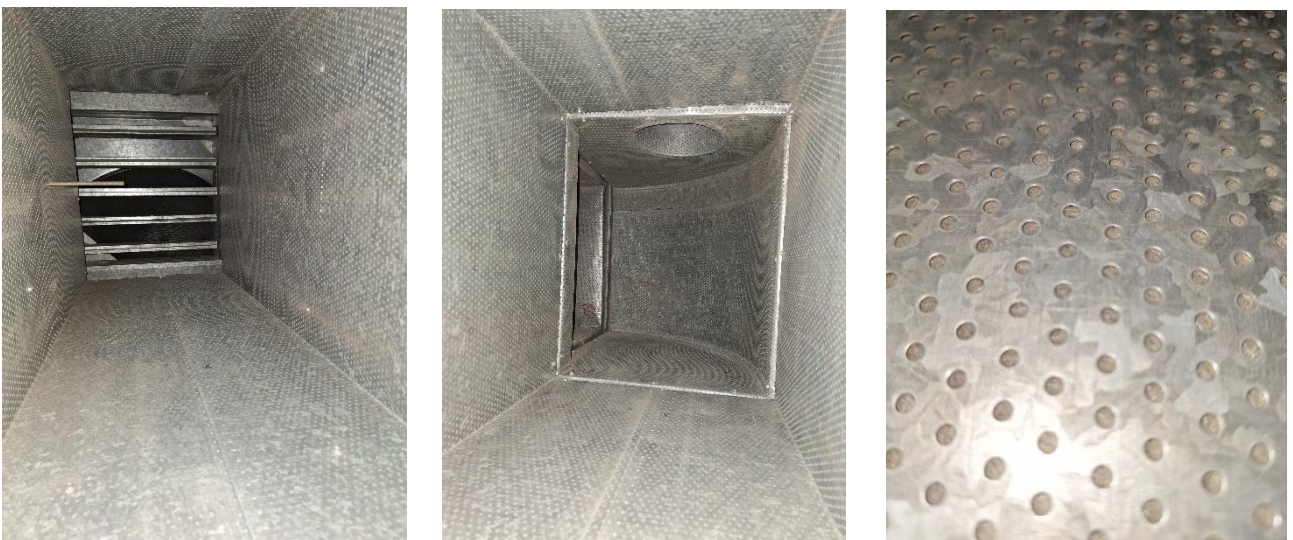
Kuva 42. Kanttikanavistossa akustointi on hoidettu reikäpellillä, jonka takana on mineraalivilla. Kanaviston kautta tulee voimakasta kuiturasitusta käyttötiloihin.
