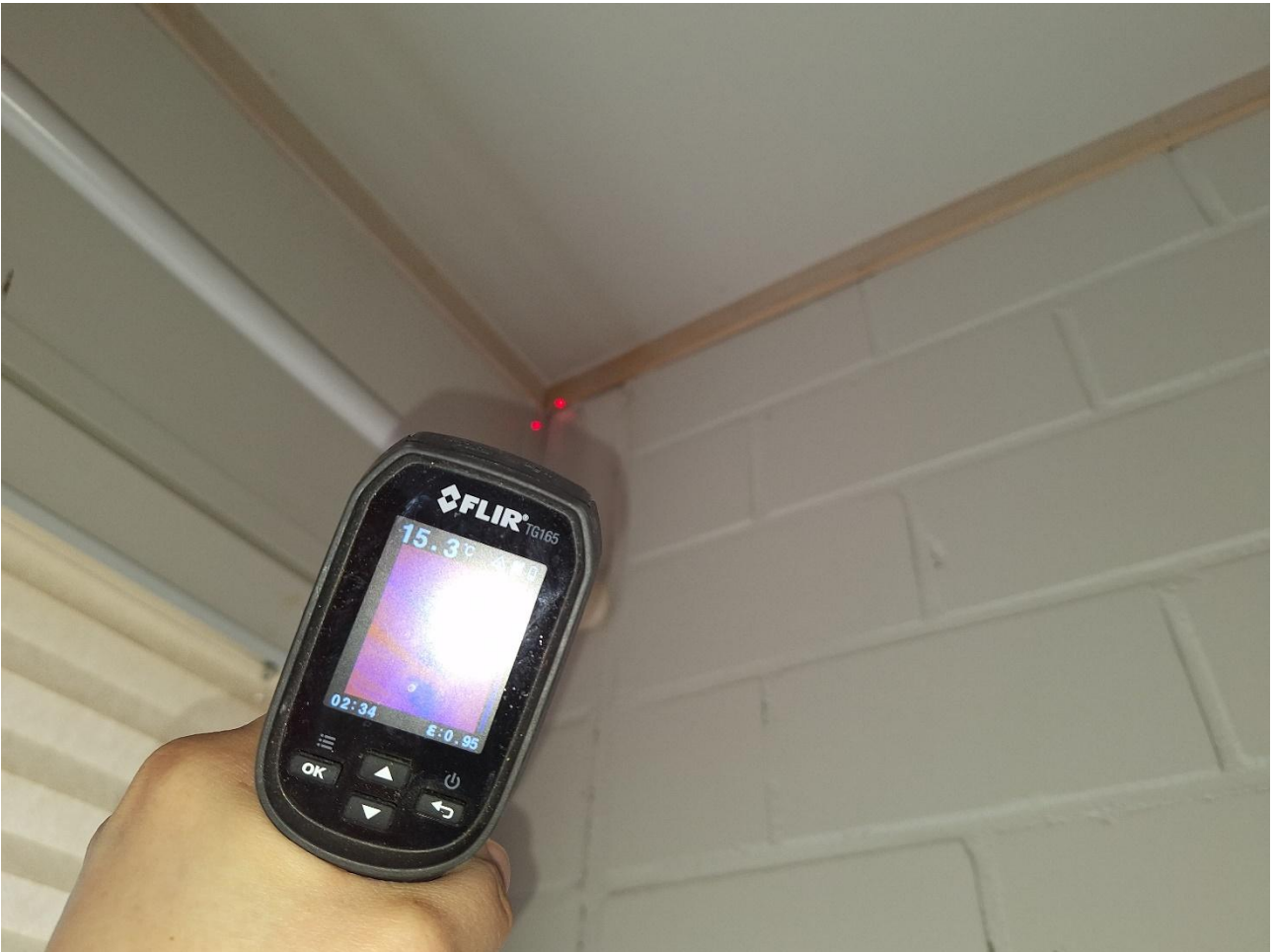
Kuva 19. Ulkokuoressa havaittiin lämpökameratarkastelussa yksittäisiä lämpövuotokohtia. Nurkassa pintalämpötila 15,3 astetta. Kuva lepohuoneen ulkoseinälinjalta.
