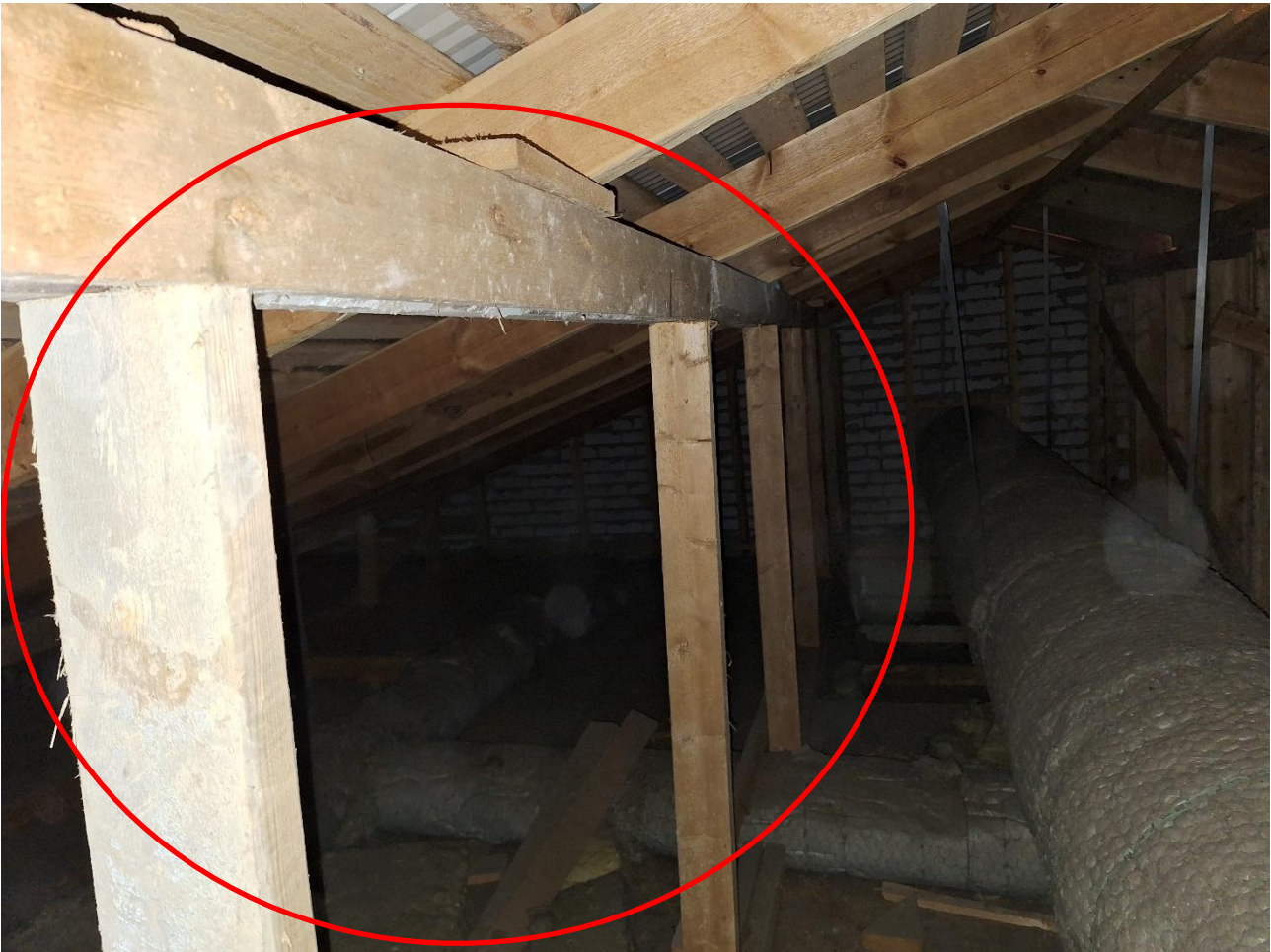
Kuva 28. Kuvassa näkyvä tukipukki on kokonaan irti, eikä käytännössä lisää katon kantavuutta.
