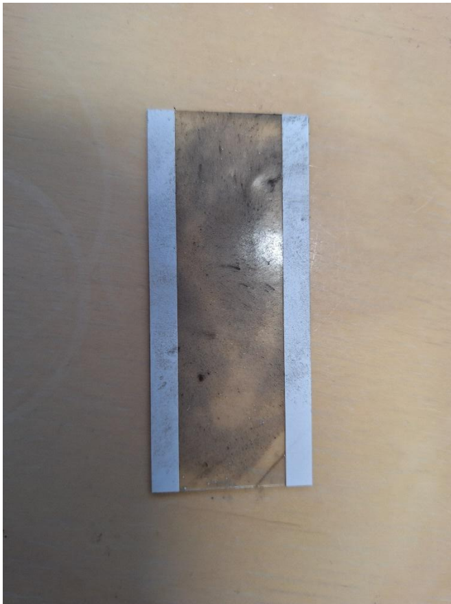
Kuva 44. Geeliteippinäyte johtajan huoneen tuloilmakanavasta. Kanavisto on nuohouksen tarpeessa.
