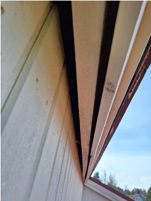
Kuva 32. Vesikaton yläpuolisissa räystäissä on paikoin niin suuret raot, että eläimet pääsevät kattorakenteisiin.
