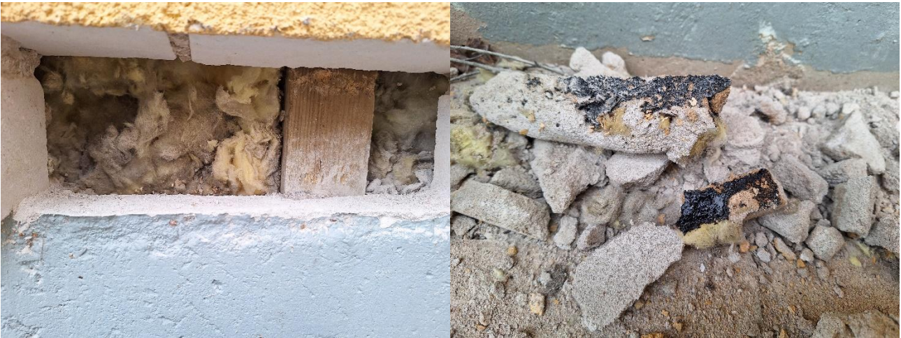
Kuva 17. Rakenneavaus johtajan huoneen ulkoseinään. Puurungosta puuttui alajuoksu kokonaan. Sokkelin päällä oli pikikäsittely. Piestä otettiin PAH-näyte.
