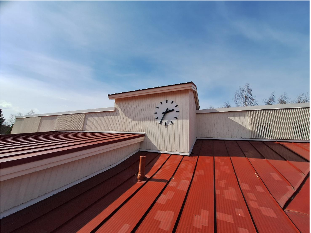
Kuva 30. Muovipinnoitetussa konesaumatussa teräslevyssä on valmistusvaiheen tyypivika, minkä vuoksi kate ei saavuta käyttöikätaivoitettaan. Muovipinnoite on irtoillut reilusti, vaikka ikää on vasta 35 vuotta. Katetta on paikkailtu vuosittain. Paikka-aineetkaan eivät pysy kauaa, ellei muovipinnoitetta poisteta välistä.
