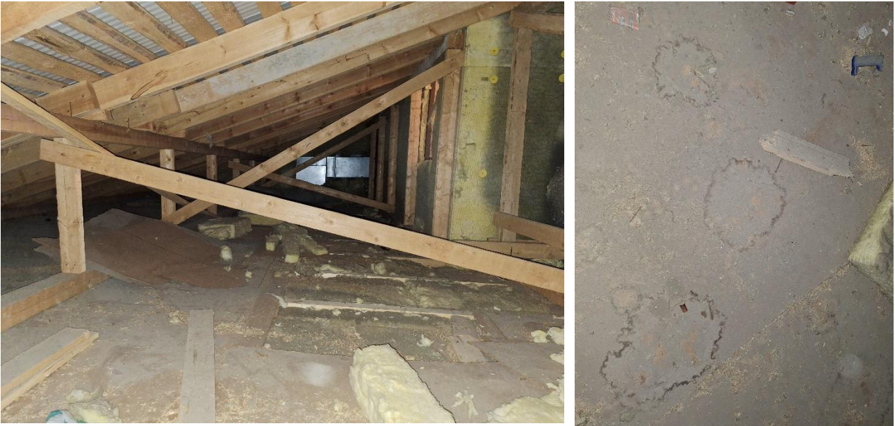
Kuva 27. Vasen kuva: Aluskatteita ei ole. Vesi tiivistyy peltikaton alapintaan pilvettömällä ilmalla lämpötilan laskiessa. Taustalla näkyy eristämätöntä tuloilmakanavistoa. Oikea kuva: eristeiden päälle tippunutta kondenssivettä.
