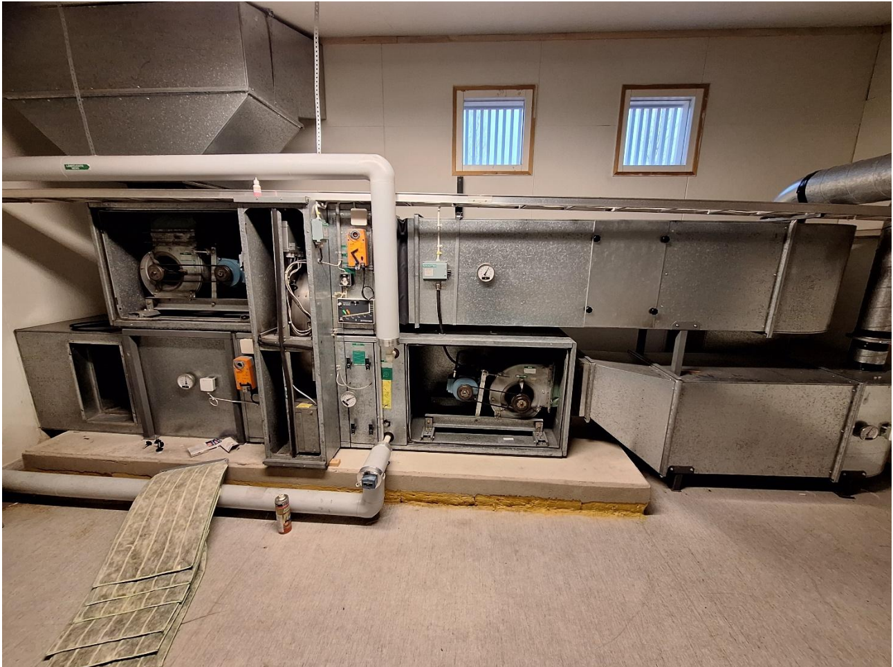
Kuva 36. IV-kone sivuluukut avattuina.
