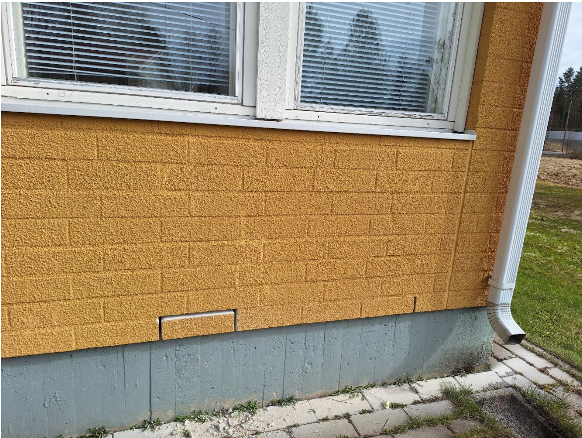
Kuva 14. Luoteispuolen Ikkunapellitysten kallistus on nykysuositusta vähäisempi. Tiiliverhouksen alimman rivin saumoista joka kolmas on auki tuulettavuuden varmistamiseksi.
