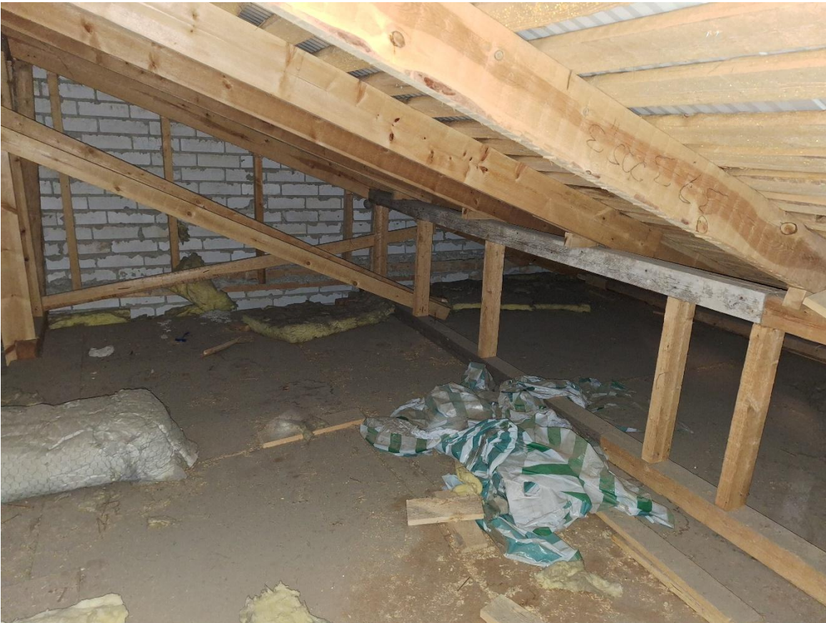
Kuva 26. Yleiskuvaa tuulettuvasta yläpohjasta. Yläpohjaan on jätetty rakennusjätettä.
