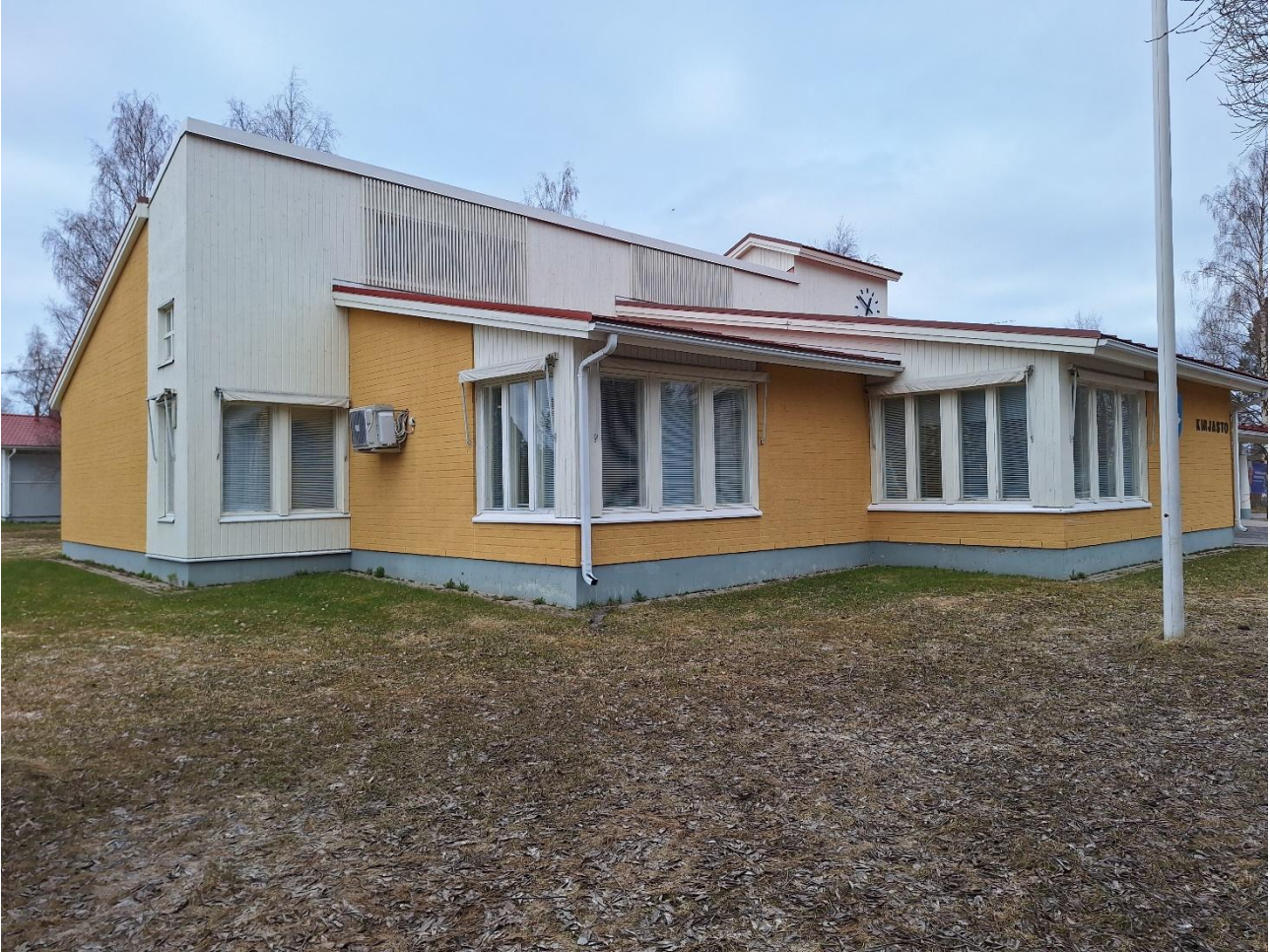
Kuva 15. Etelän puoleisissa ikkunanpuitteissa on osin lahoa ja osin maalauksen tarvetta. Markkiisit ovat käyttöikänsä päässä.
