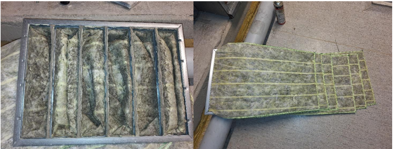
Kuva 41. Tulo- ja poistoilmasuodattimet olivat kohtalaisessa kunnossa. Vaihtoajankohtaa ei ollut kirjattu näkyville.
