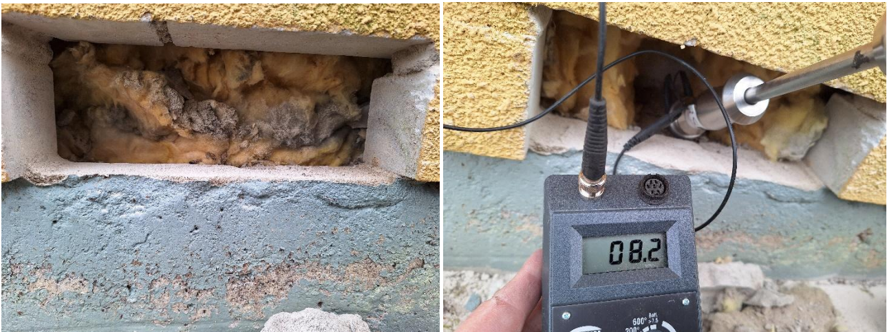
Kuva 18. Rakenneavaus teknisen tilan ulkoseinään. Puurungosta puuttui alajuoksu. Sokkelin päällä oli pikikäsittely. Kosteusmittaus tehtiin eristeestä.
