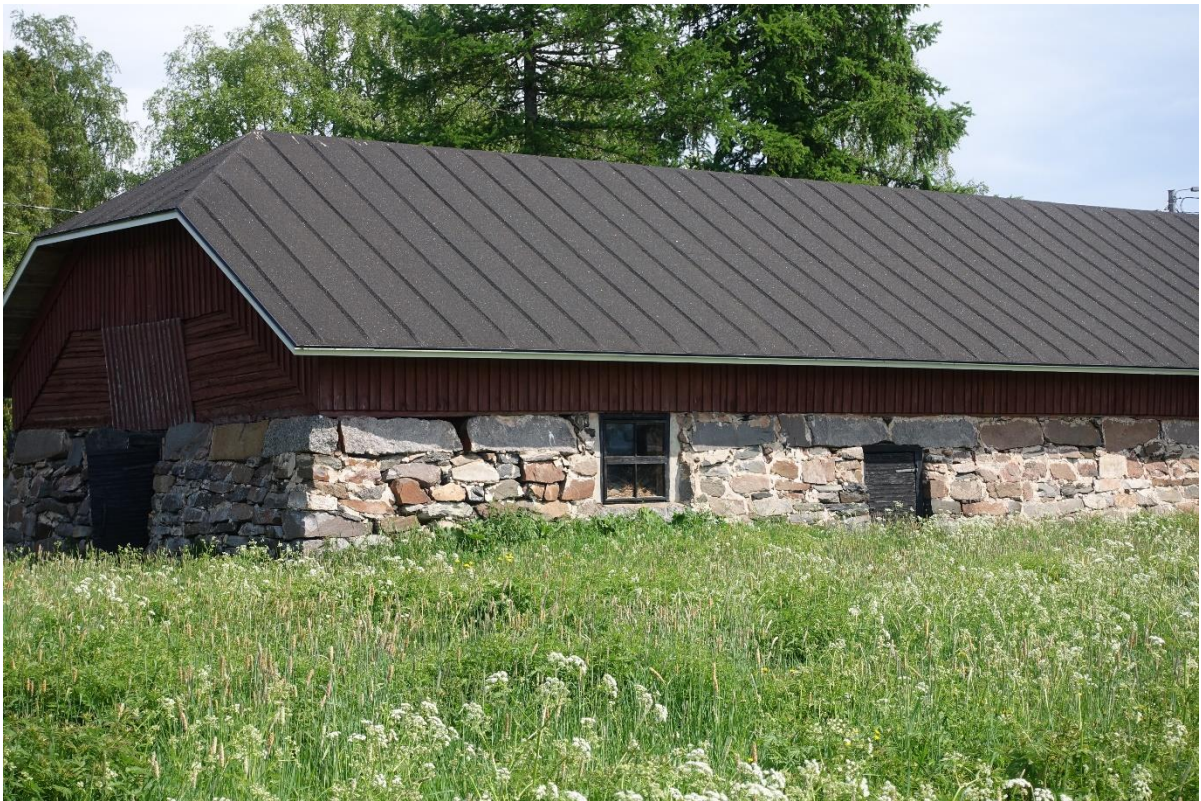
Kuva 60. Kiviseinä on muutamasta kohdasta sortunut. Kattomuoto vaikuttaa siltä, että sen on haluttu suojaavan rakennuksen seiniä erityisen hyvin. Alkuperäisessä katossa on todennäköisesti ollut lyhyemmät räystäät.
