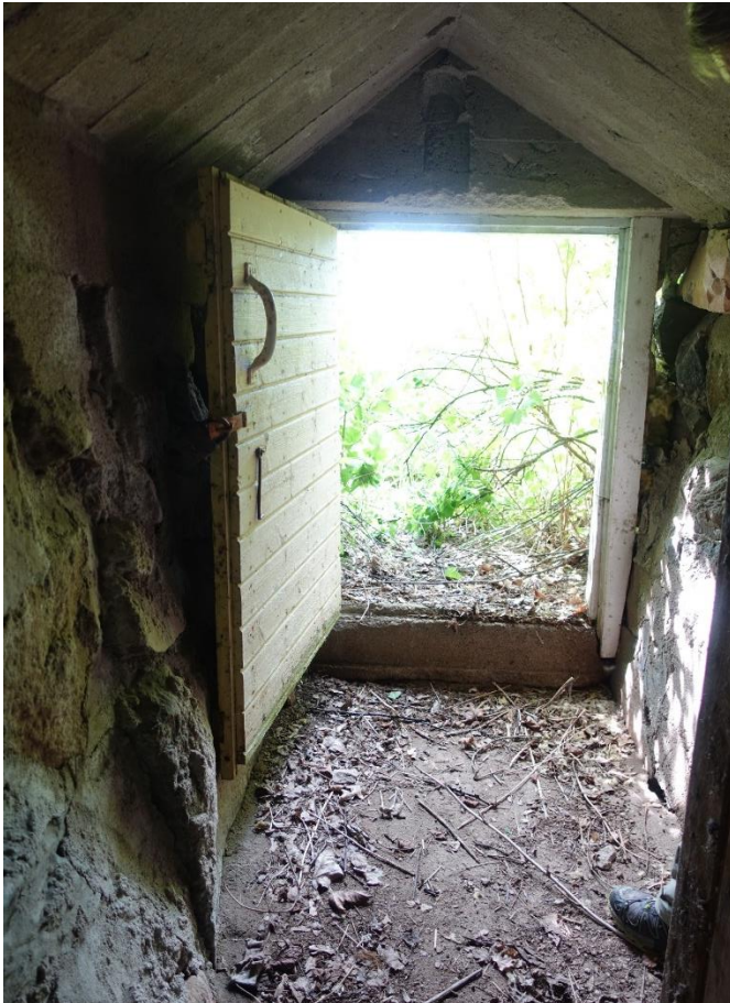
Kuva 77. Eteisessä näkyy vielä kivien muoto betonin alta.
