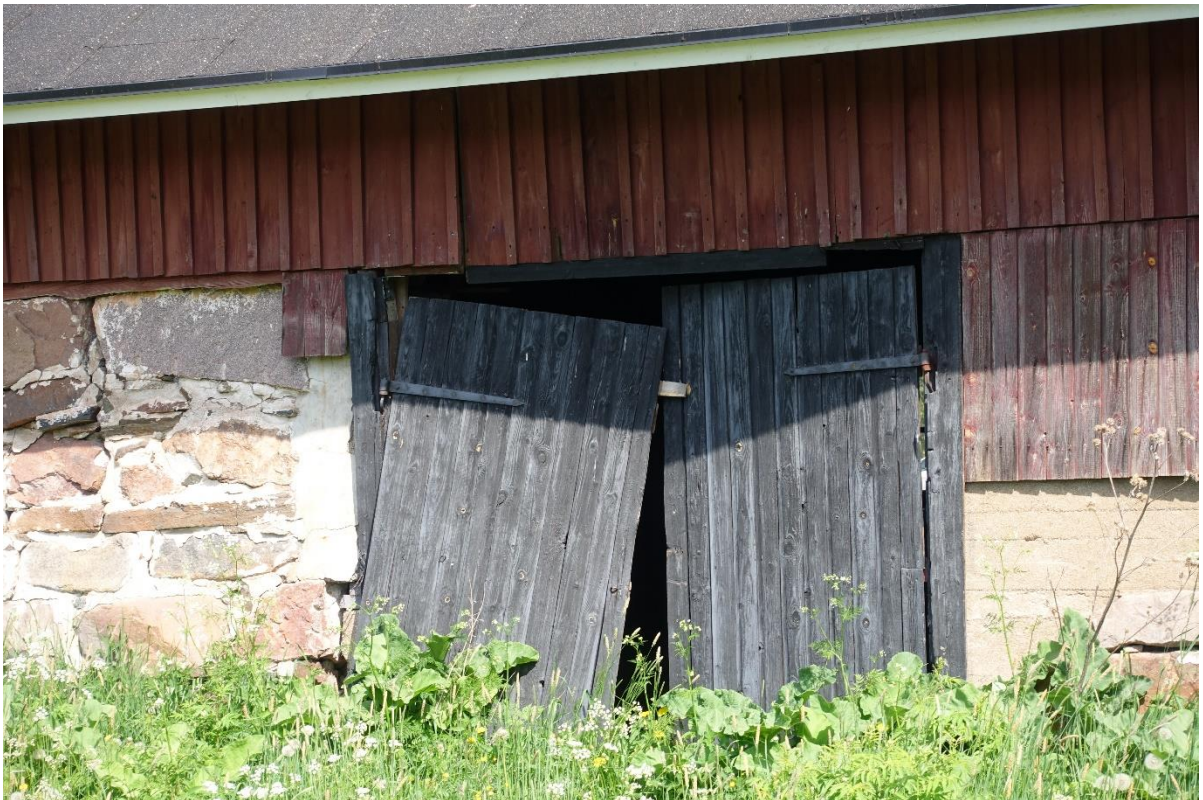
Kuva 62. Navetassa on pariovet. Seiniä on korjailtu myös betonilla ja laastilla.
